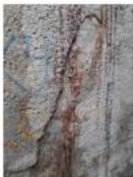
Figura 1.3 - Perdite di spritz-betone distaccato dal supporto
