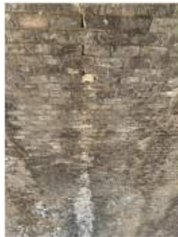
Volto rampante 2 - fessure lungo le giunzioni orizzontali
