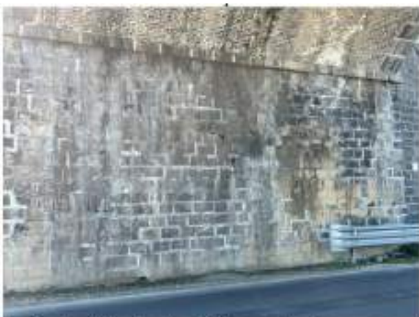
Spalla - Macchie d'umidità e percolazione acqua
