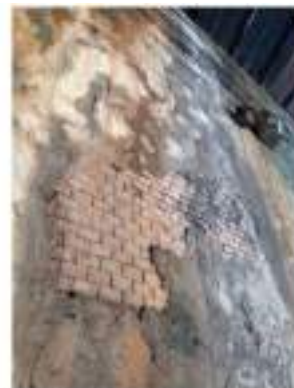
Spalla lato Pozzuoli: disgregazione mattoni, perdita malta nei giunti
