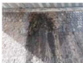
Spalla 1 - Infiltrazioni attraverso la muratura
