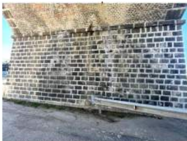
Pila - Macchie d'umidità e percolazione acqua
