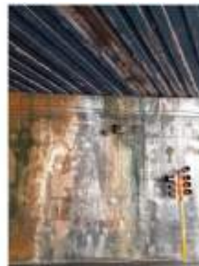
Spalla lato Pozzuoli: disgregazione mattoni, perdita malta nei giunti, infiltrazione attraverso la muratura
