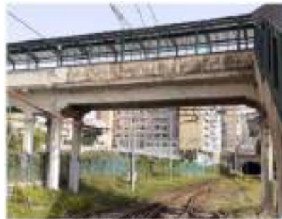
Passerella: Ammaloramento del cls
