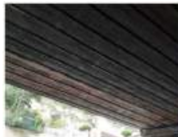
Piattabande: Distacco vernice protettiva e presenza di ruggine
