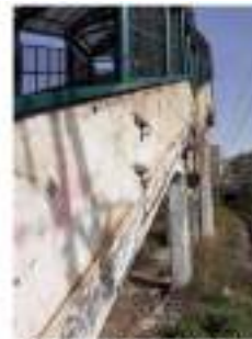
Scala: Ammaloramento del cls
