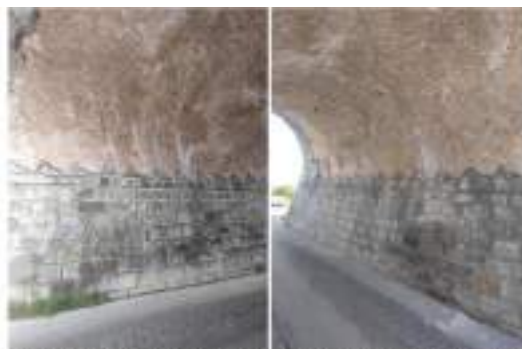
Figura 13 - Diffusi macchie di efflorescenza sull'interfaccia intradosso delle volte e presenza di buche in suo in alcuni punti
