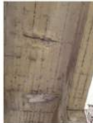
Scala: Ammaloramento del cls e ferri esposti
