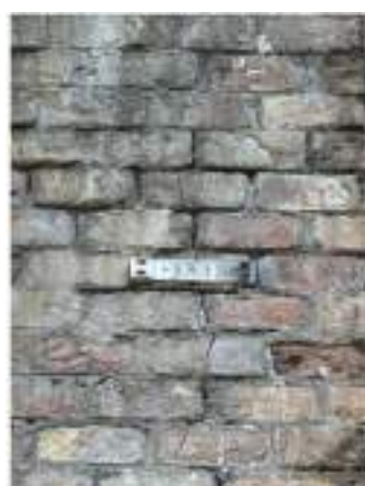
Volta campata I - Fessura lungo le giunzioni e nei mattoni - lato stallo settore volta lato Pozzoli
