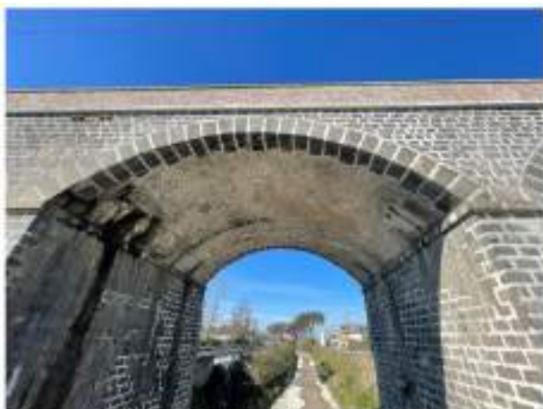
Campata 2 - Macchie d'umidità e percolazione acqua su volta e pila
