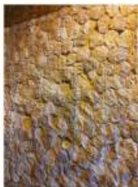
Figura 1.4 - Spalle deterioramento della ristilatura nelle giunture roschi disgregazione degli elementi
