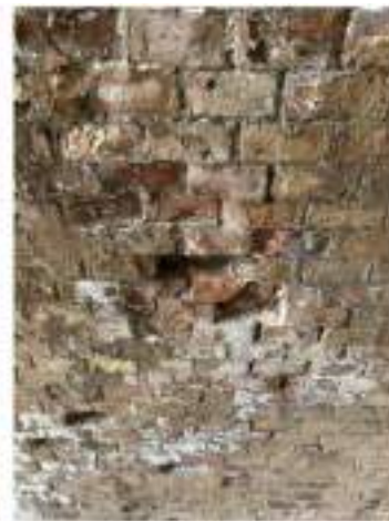
Volto rampante 3 - elementi di muratura rotti
