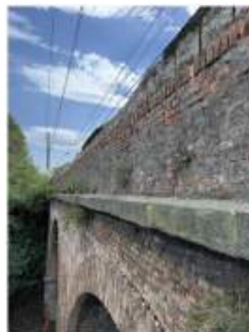
Parapetto - perdita di materiale nelle giunzioni e cordolo in c.a. degradato
