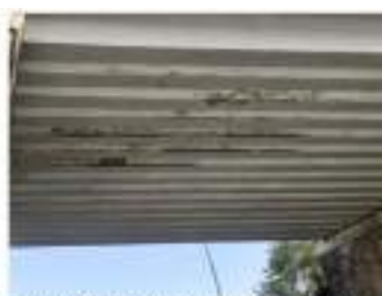
Spalla 1 - Perdita di vernice protettiva con ossidazione ed infiltrazione attraverso il c.a. del sottotrave
