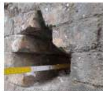
Fila Loro Pozzoli - elementi di muratura mancanti e rotti
