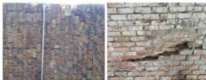
Fessura sub-trasversale nella Volta (3) (osservazione)
