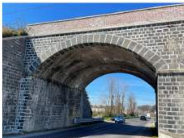
Campata 3 - Macchie d'umidità e percolazione acqua su volta e pila
