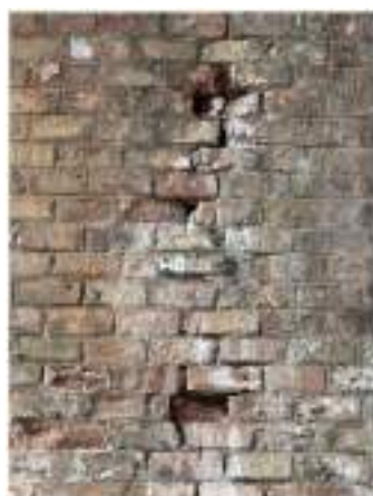
Volta campata I - Fessura lungo le giunzioni e nei mattoni
