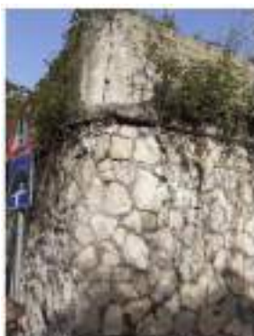
Figura 1.5 - Lesione del muro d'ala di Spalla 1
