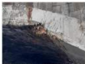
Arco sovrasto – Danno da urto con degradazione mattoni
