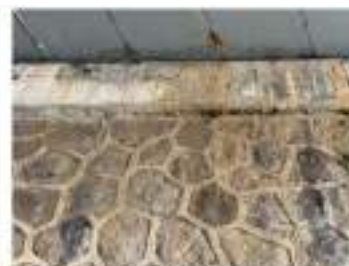
Figura 1.4 - Percolazione d'acqua nelle zone di appoggio e conseguente distacco di terreno per ossidazione
