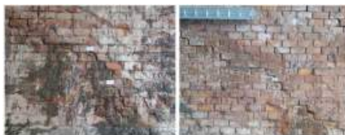
Fessura diagonale nella Volta (1) (osservazione)
