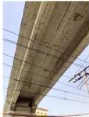
Passerella: Ammaloramento del cls e ferri esposti
