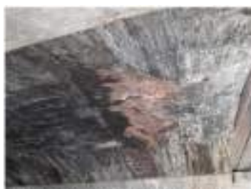
Volte – Infiltrazioni attraverso la muratura ed efflorescenze
